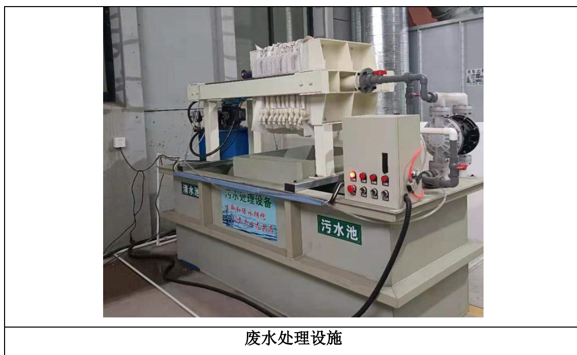
图 4-3 废水处理设施照片
