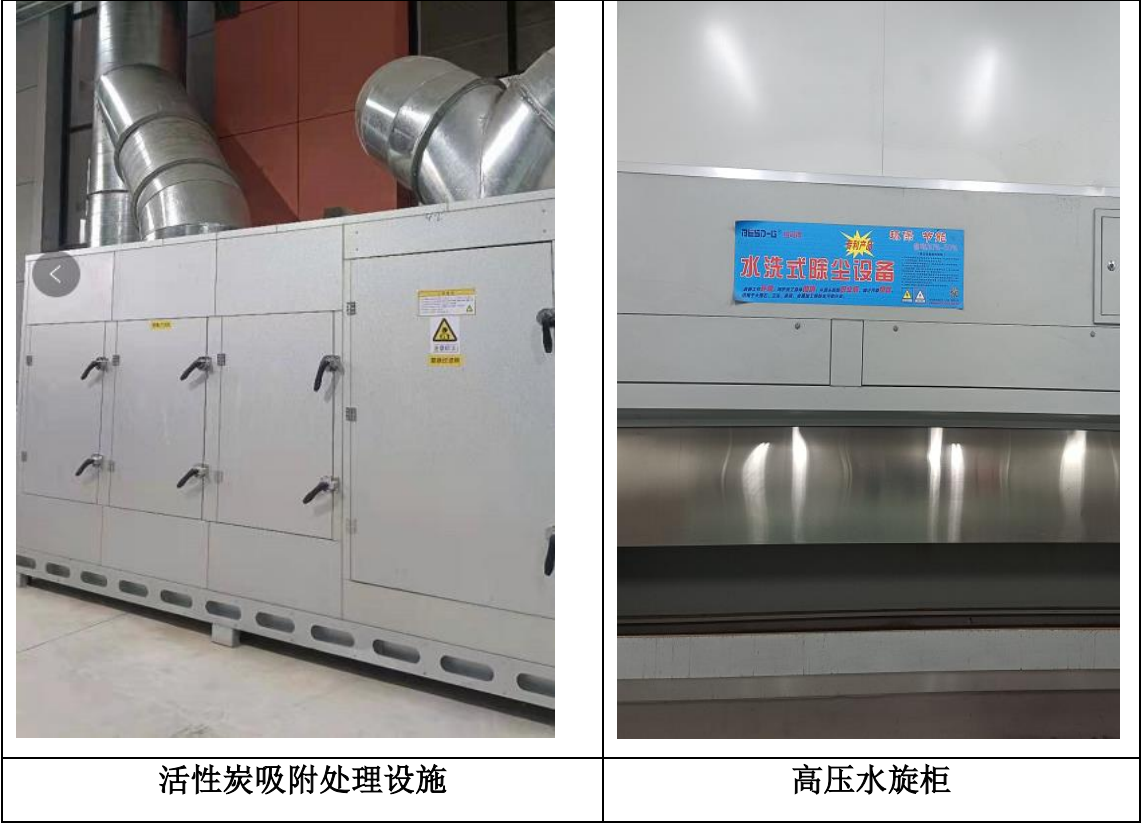
图 4-6 废气处理装置
